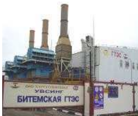
Рис. 2. вид ГТЭС с газотурбинной установкой ГТУ-4П
