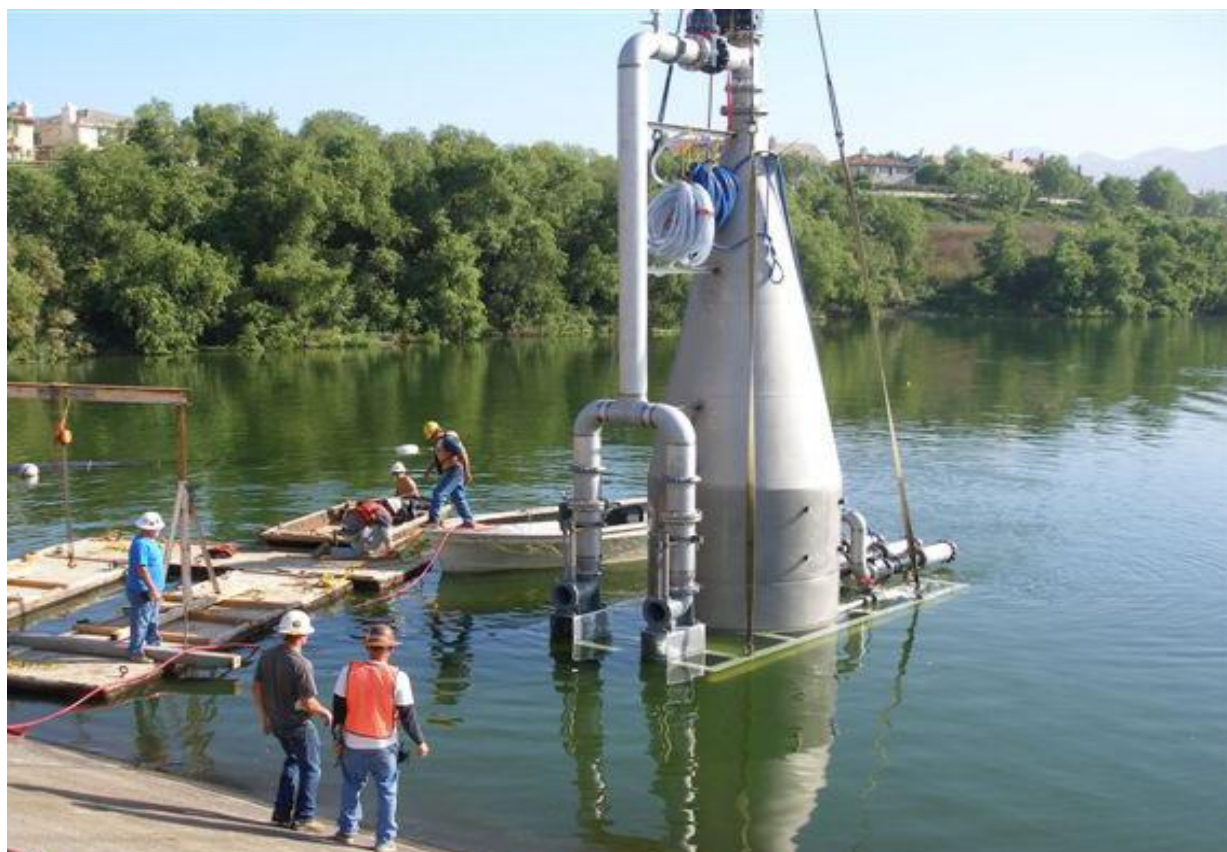
Рис. 2.1.11. Установка конуса Списа для оксигенации водных масс водоема (www.wvconstructioncompany.com/portfolio/oso-reservoir)
