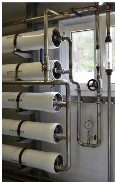
Узел обеззараживания сточных вод озонированием
